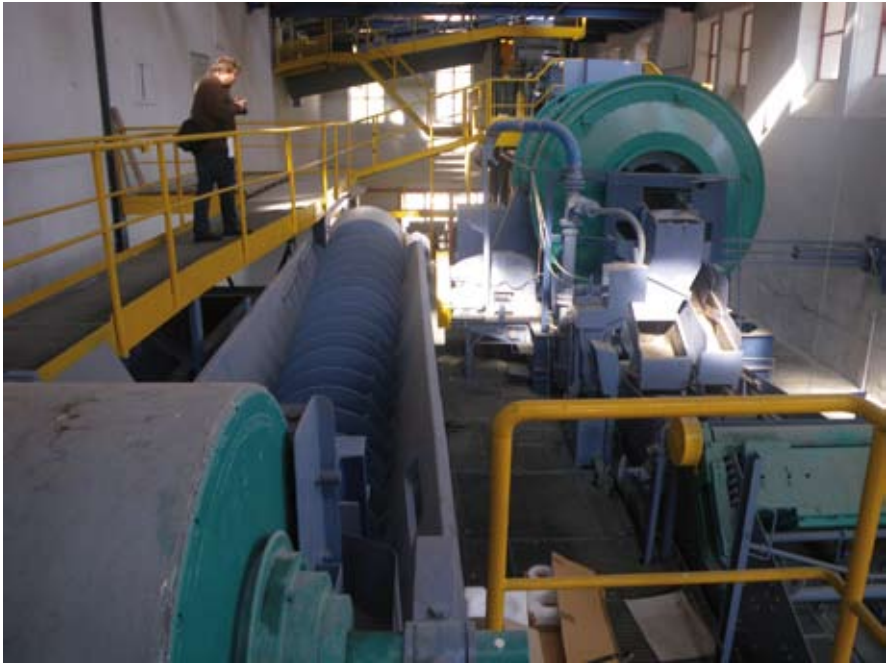
Abb. 12.j: Erzaufbereitungsanlage Bleiberg/Kärnten, Innenansicht, im Bild Jens Pfeifer, Foto 2012
