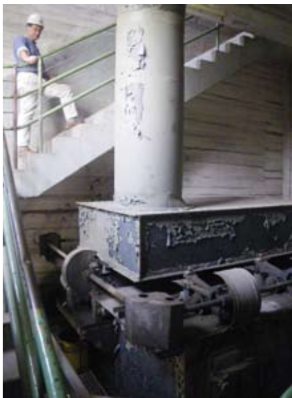
Abb. 5.2.o: Beth-Schlauchfilter, im Hintergrund Stefan Dützer, Foto 2012
