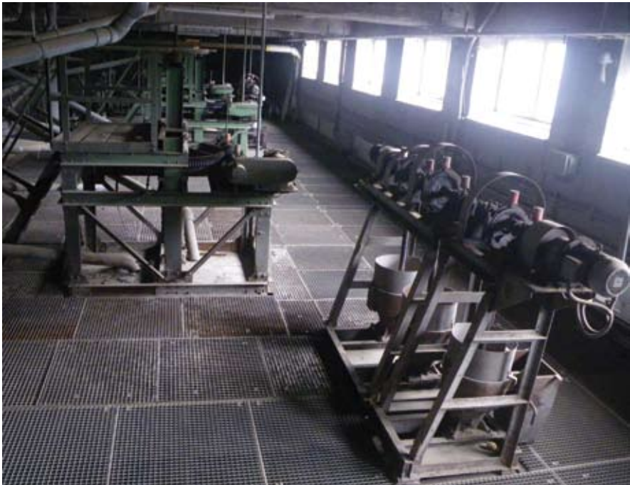
Abb. 9.8.b: Plungerpumpe und Krählerwerksantrieb auf der Pumpenbühne, Foto 2012
